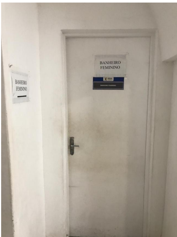
Imagem 05 – Porta de Banheiro Acessível sem identificação.
