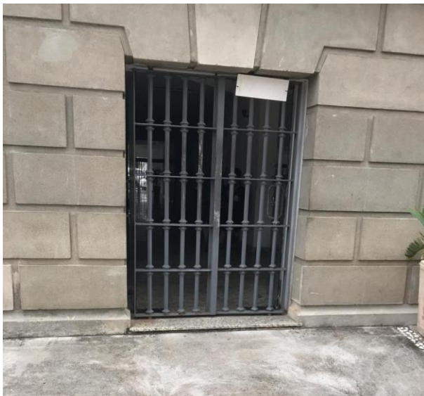
Imagem 04 – Acesso de rota acessível sem identificação.
