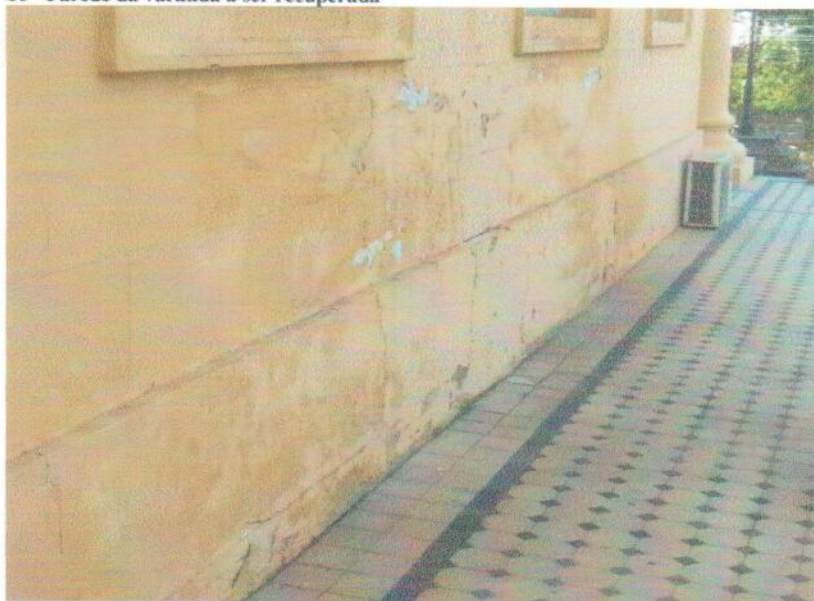
10 - Parede da varanda a ser recuperada
