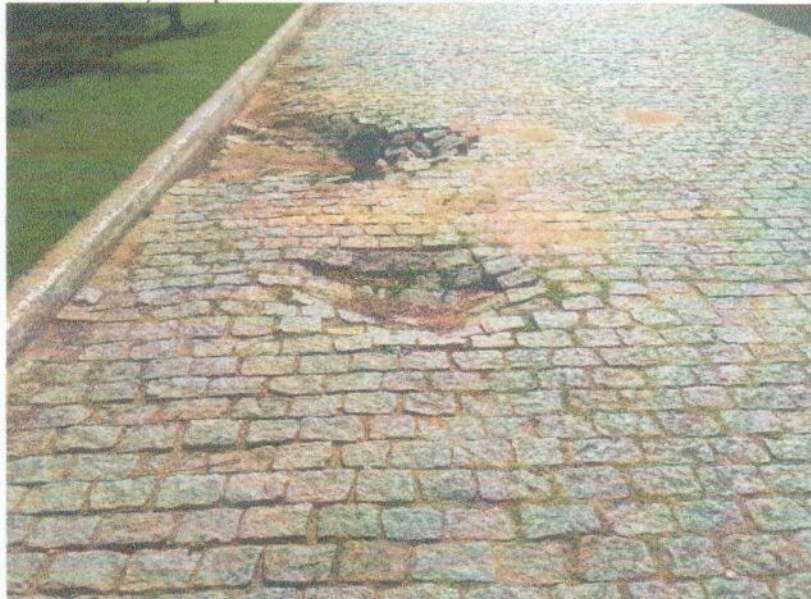
16 - Pavimentação em paralelo do estacionamento com afundamentos
