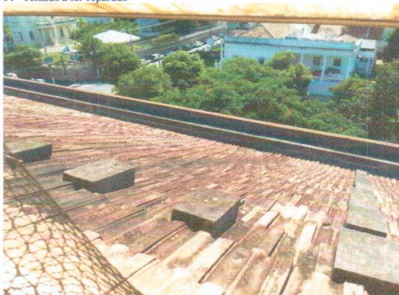
04 - Telhado a ser reparado
