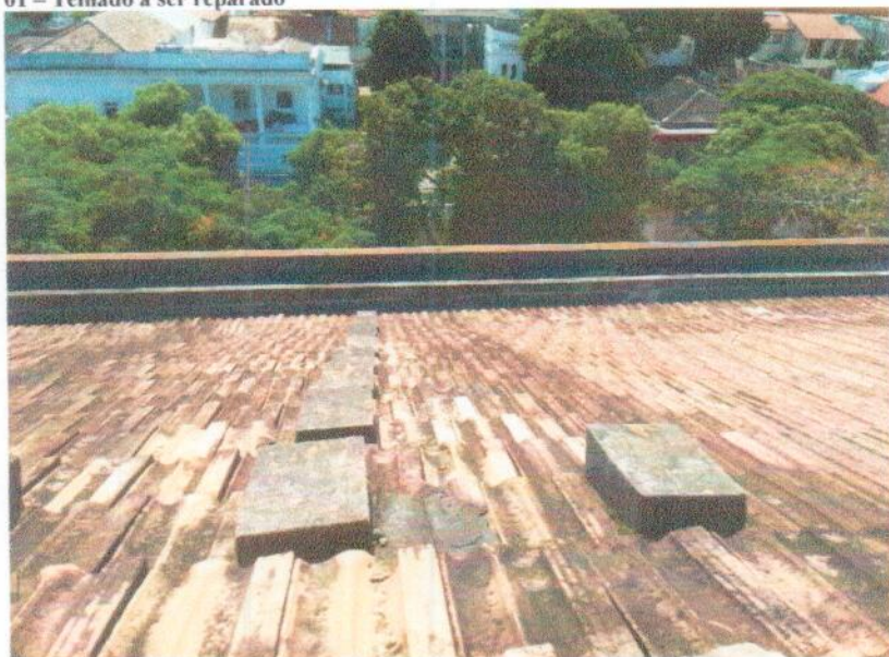
01 - Telhado a ser reparado
