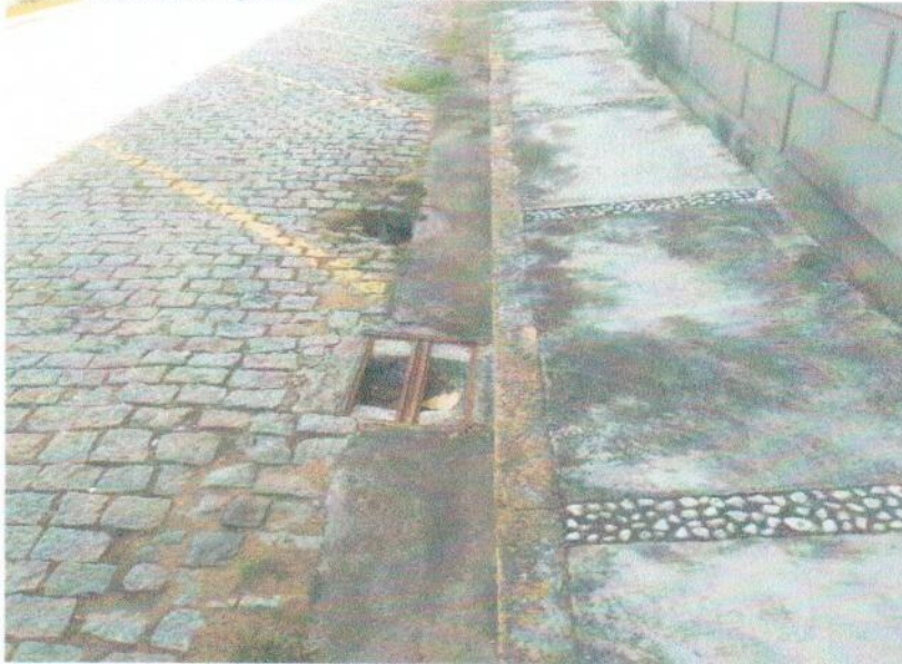
18 - Pavimentação em paralelo do estacionamento com afundamentos
