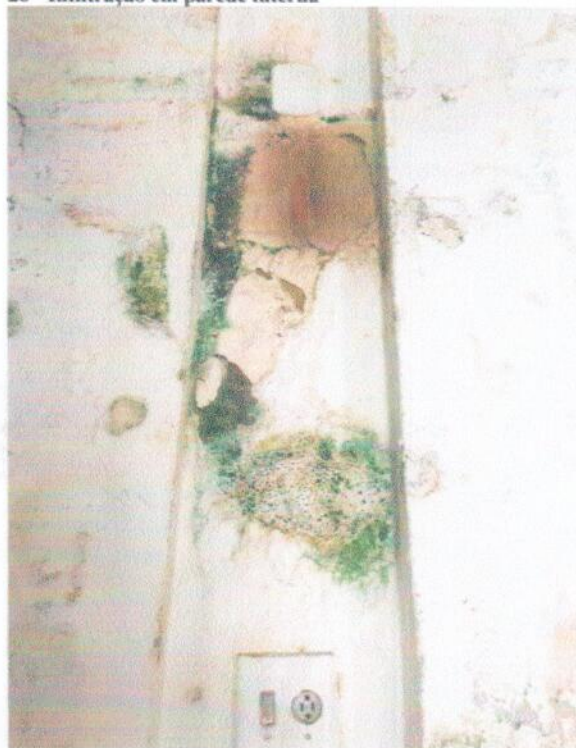
26 - Infiltração em parede interna
