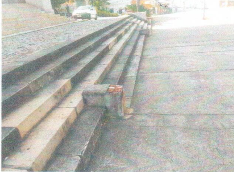
06 - Calçada interna danificada
