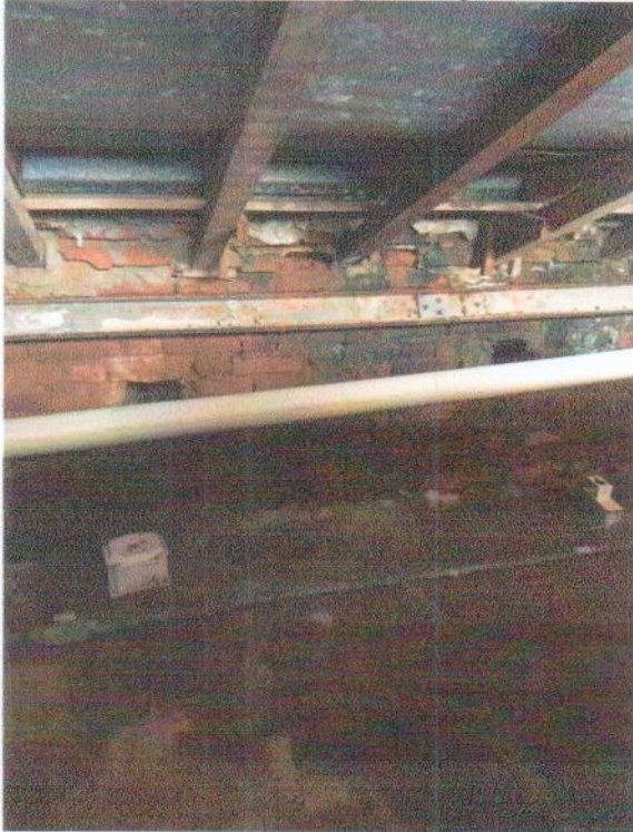
20 - Infiltração sob o telhado com parede da platimbanda a recuperar
