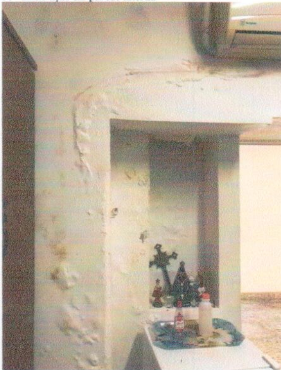
30 - Infiltração em parede interna
