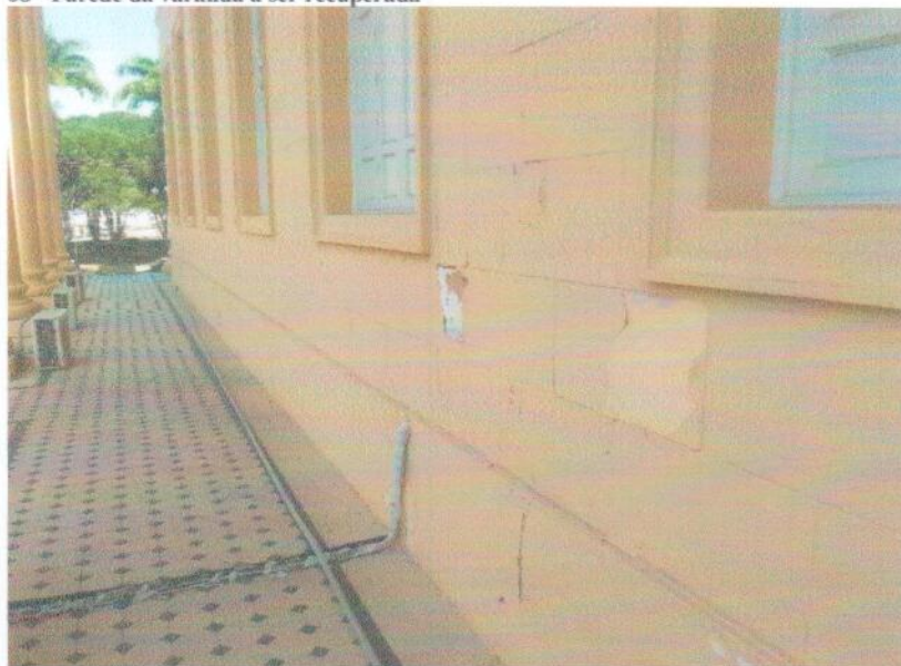
08 - Parede da varanda a ser recuperada
